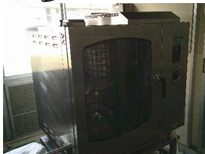
スチームコンベクション オープン
